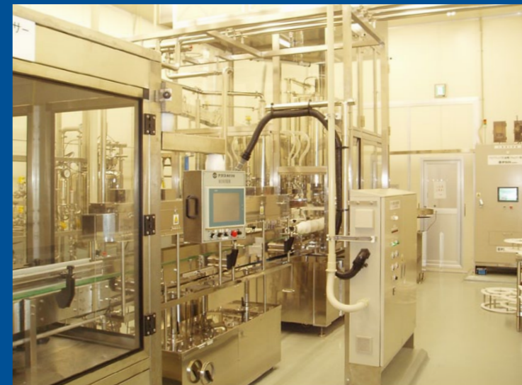
すすぎ用リンサー（手前）と無菌充填機/サーボキャッパー（奥）。クラス1000のクリーンルーム内にクラス100のクリーンブースを設備した無菌充填室
