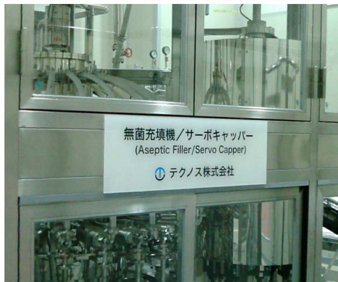
クラス 1000 のクリーンルーム内にクラス 100 のクリーンブース付 無菌充填機 / サーボキャッパーを設備した無菌充填室
