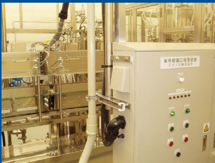
紫外線壇口殺菌装置の制御盤
