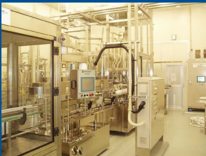
すすぎ用リンサー（手前）と無菌充填機/サーボキャッパー（奥）。 クラス1000のクリーンルーム内にクラス100のクリーンブースを 設備した無菌充填室
